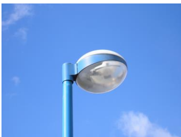
Typ Trilux 9081 (Foto: Tiefbauamt)
