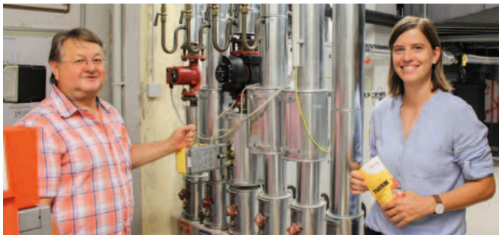
Michael Fialik, selbstständiger Heizungsinstallateur, und Stefanie Nehlert von den Stadtwerken Gotha beraten zum Wärmecontracting.
