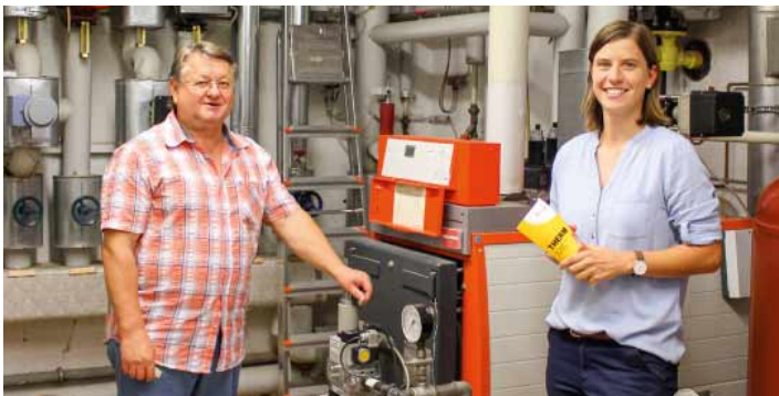
Michael Fialik, Heizungsinstallateur mit eigener Firma, und Stefanie Nehlert von den Stadtwerken Gotha beraten Interessierte zum Wärmecontracting.
