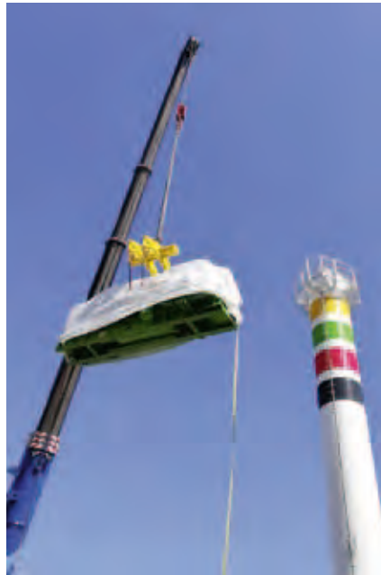
Am 26. April traf der zweite Motor für das neue HKW der Stadtwerke Gotha in der Breiten Gasse 1 ein.
