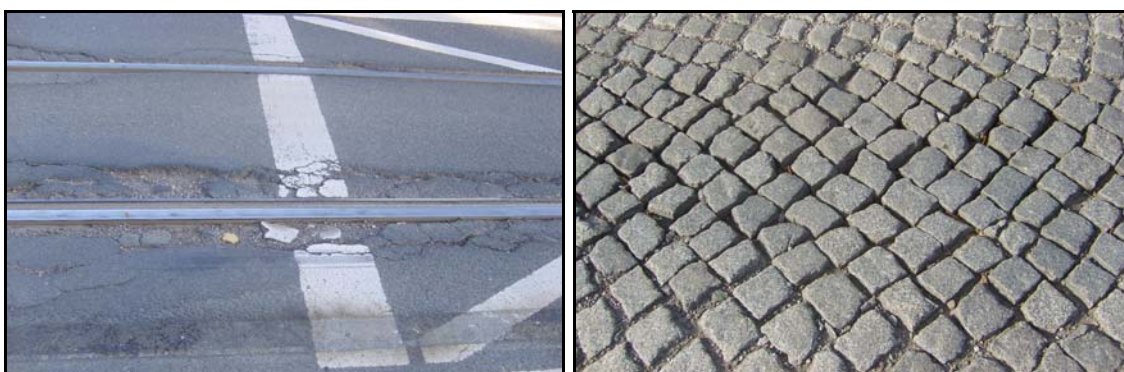
Abb. 5: Oberflächenschäden Gleisbereich Friedrichstraße bzw. Pflasterabschnitt Cosmarstr.
