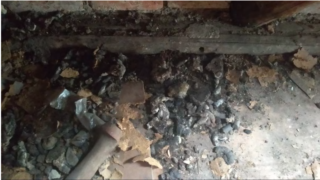
Abb. 7: Waschbärkot im Dachstuhl festgestellt
