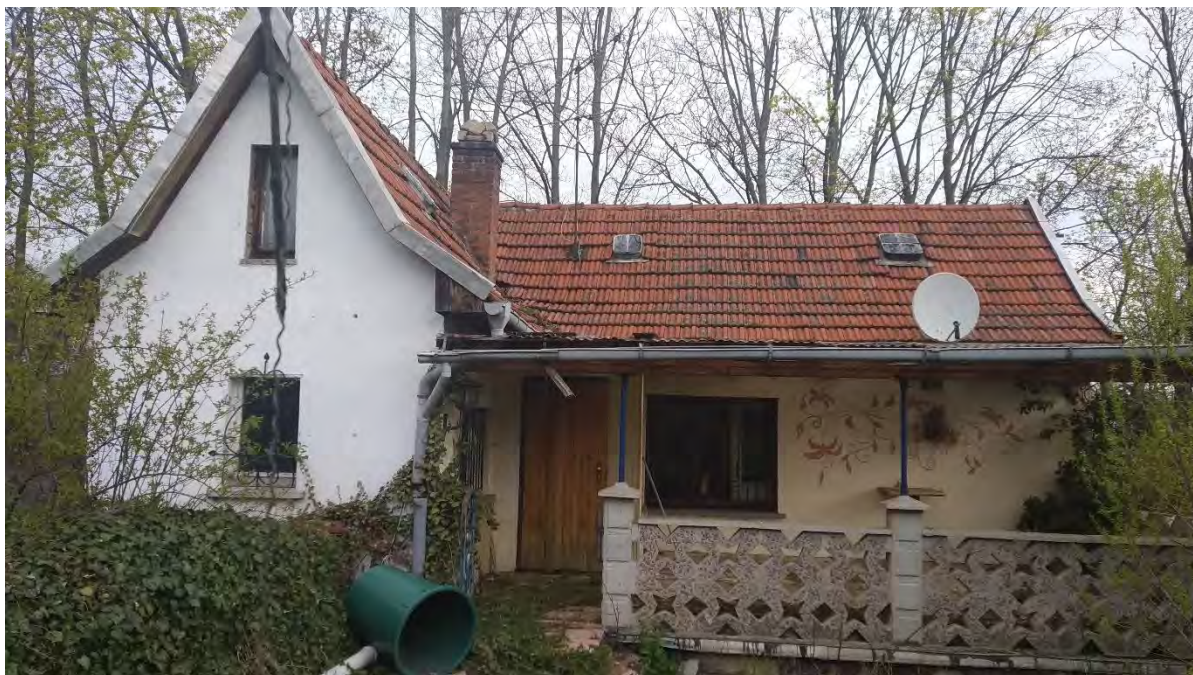
Abb. 5: Gebäude mit ungedämmtem Dach
